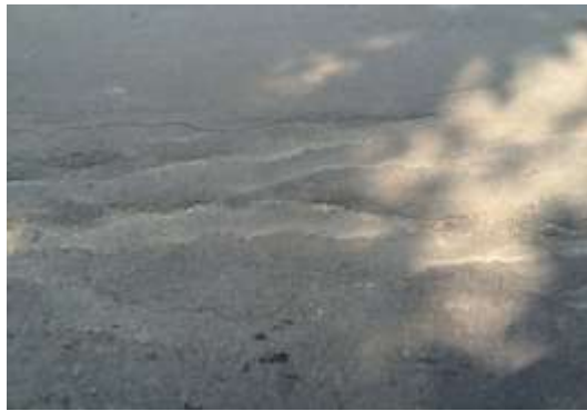
Gambar 5. Retak Pinggir / Edge Crack
