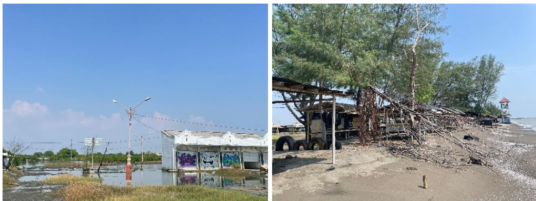
Gambar 2. Kondisi Pantai Randusanga Brebes Sumber: Dokumentasi penulis, 2026
