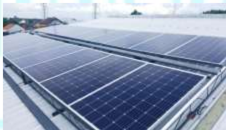
Gambar 17 Sistem Teknologi Energi Panel Surya
