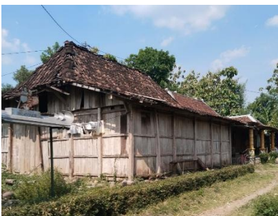
Gambar 5. Kondisi Rumah Tidak Layak Huni di Sabuk Hijau Sumber : Dokumentasi Penulis, 2025
