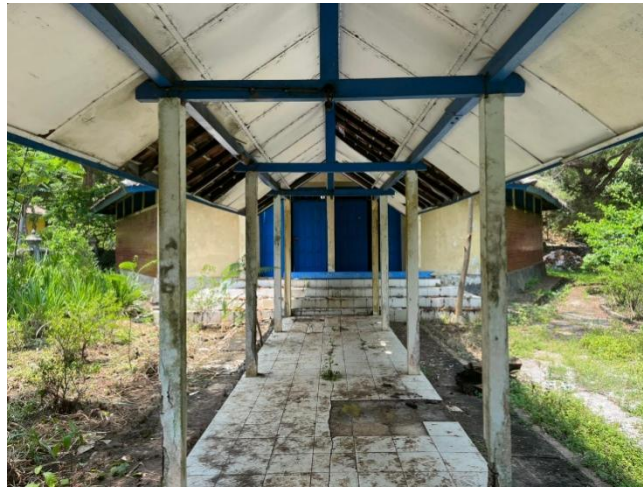
Gambar 3. 4 Kondisi Bangunan Akuarium Pantai Kukup
