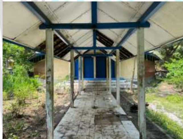
Gambar 6. Kondisi Bangunan Aquarium Pantai Kukup (Sumber: Dokumentasi Pribadi Penulis, 2026)
