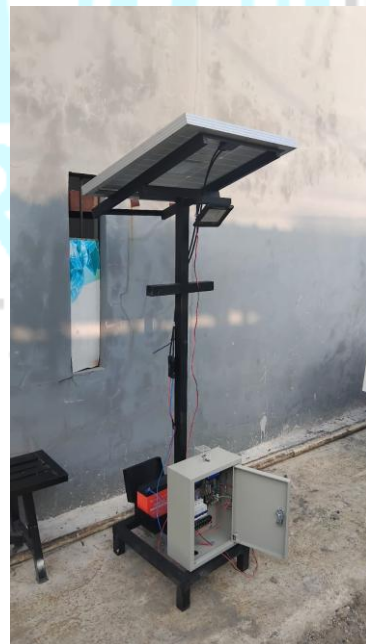
Gambar 5b. Implementasi Sistem Hardware Tampak Keseluruhan
