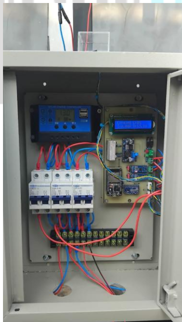
Gambar 5a. Implementasi Sistem Hardware Rangkaian Elektrikal
