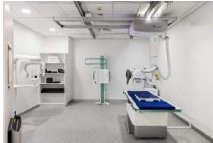
Gambar 34. Interior Ruang Radiologi
