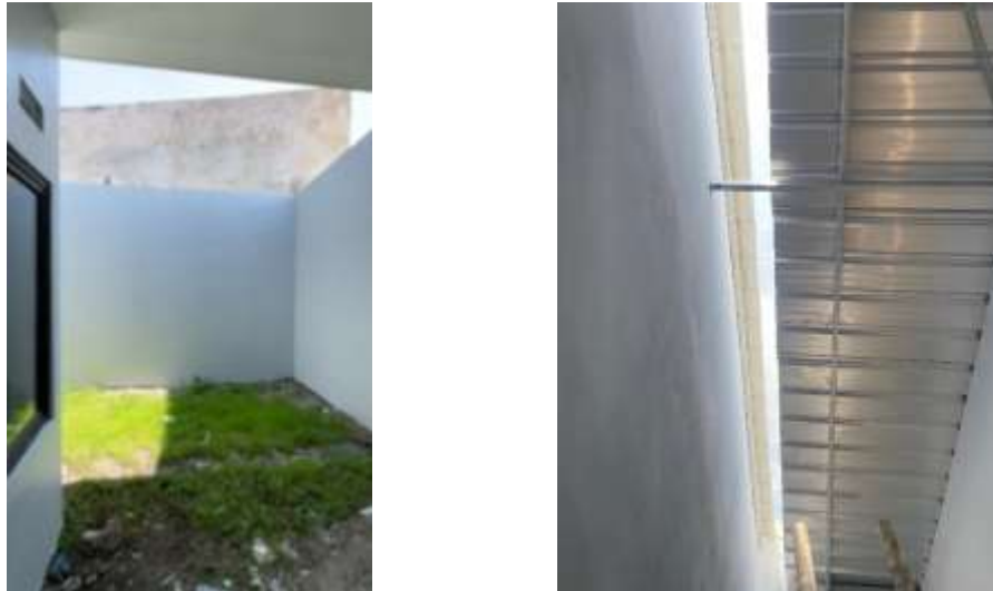
Gambar 21. Evaluasi Desain Area Belakang: (Kiri) Kondisi Void Terbuka dengan Tembok Batas Tinggi pada Marison Regency yang Memicu Renovasi Buntu, (Kanan) Solusi Integrasi Atap Tertutup dan Dinding Roster Berpori (Breathable Wall) pada Paloma Graha
