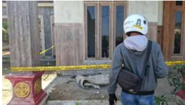
Gambar 1. 8 Kerusakan Rumah Warga Akibat Bentrok Antar Perguruan Sumber : jatim.idntimes.com , 2025
