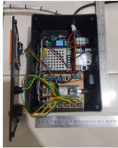
Gambar 8b. Control box tampak dalam
