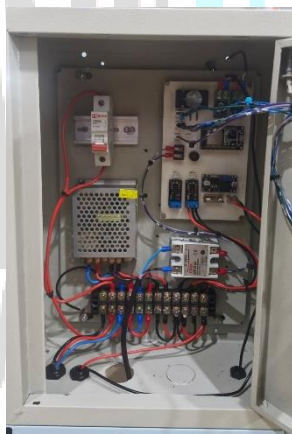
Gambar 3.2. 1 Tampak dalam Box Panel
