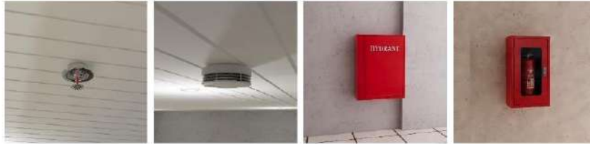
Gambar 12. Perangkat Proteksi Kebakaran dalam Ruang
