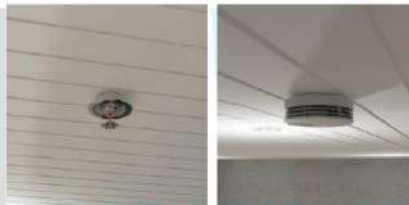
Gambar 17. Sprinkler dan Smoke Detector
