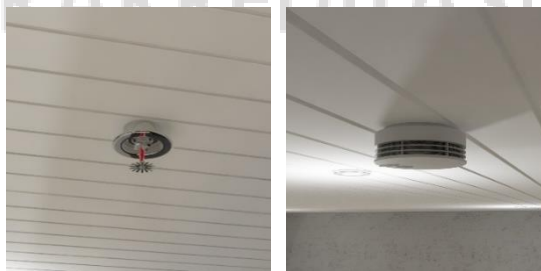
Gambar 17. Sprinkler dan Smoke Detector
