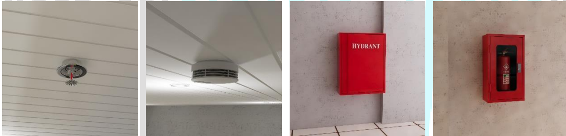
Gambar 12. Perangkat Proteksi Kebakaran dalam Ruang
