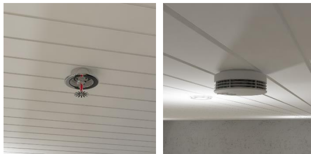
Gambar 116. Sprinkler dan Smoke Detector
