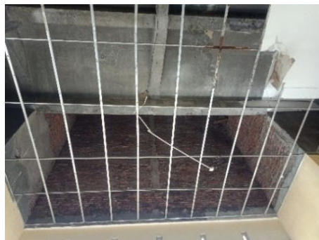
Gambar 125. Kondisi Plafon di Bangunan Timur
