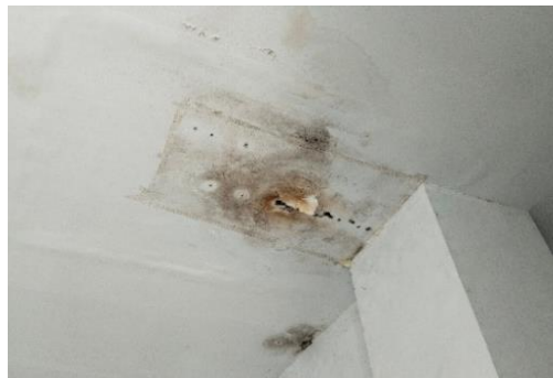
Gambar 124. Kondisi Plafon di Bangunan Barat
