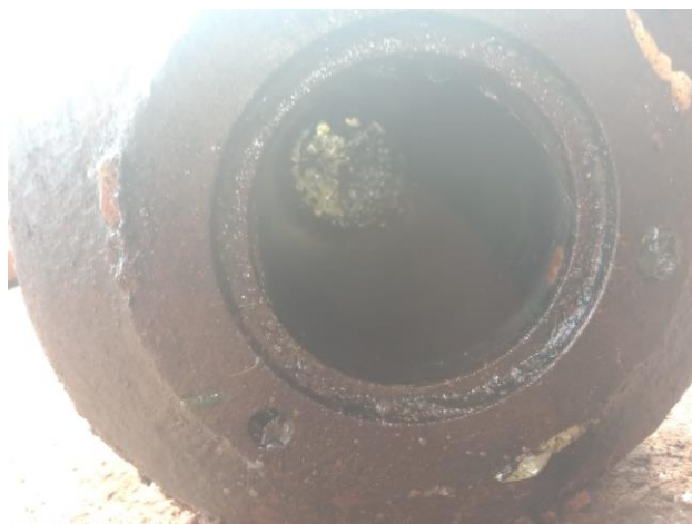
Gambar 4 Pengecekan Cylinder Rod
