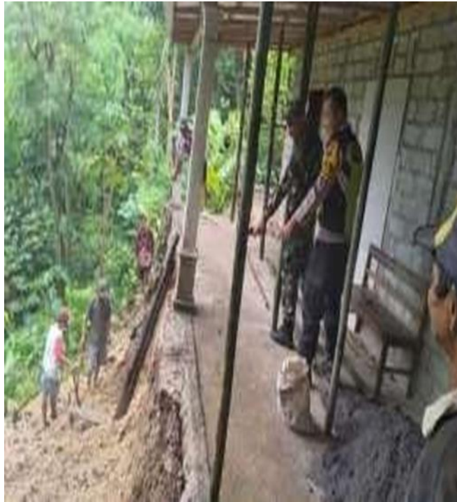
Gambar 1. 1Kejadian Longsorlahan di Kecamatan Jatiroto
