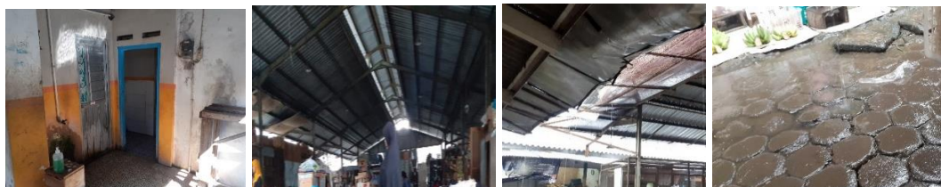
Gambar 4 Kondisi toilet, atap dan drainase di dalam pasar
