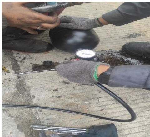
Gambar 3.11 Pengecekan tekanan Accumulator
