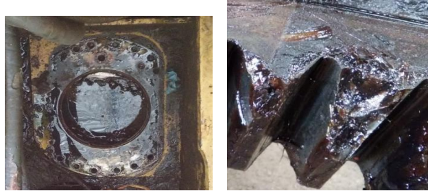
Gambar 4.11 Kondisi grease dan swing circle
