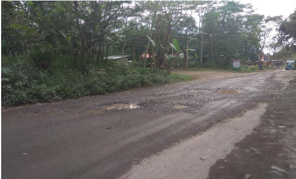
Gambar 1.1 Kerusakan Infrastruktur Jalan (21 Mei 2018)
