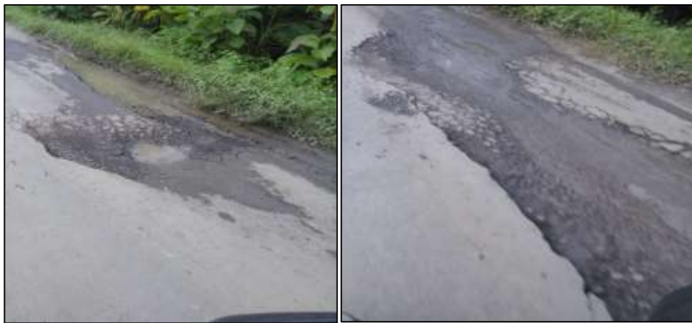
Gambar 1.1 Contoh Kerusakan Jalan di Sekitar Pantai Rembang, Jawa Tengah
