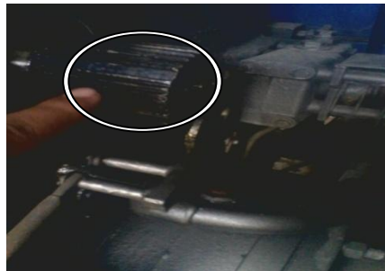
Gambar. 5 Pemeriksaan kebocoran pada lifter
