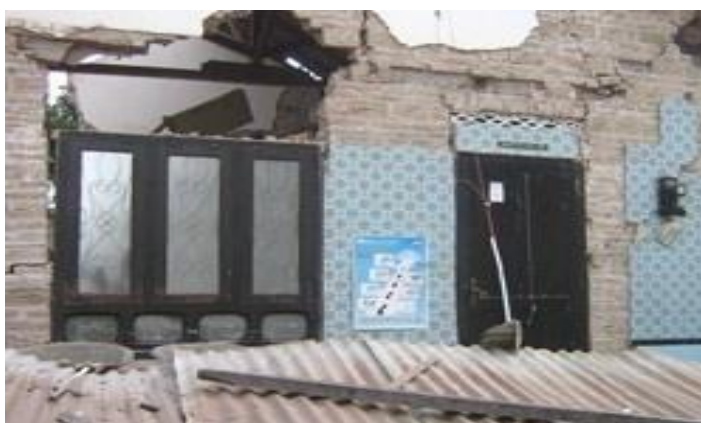
Gambar 1.1 Gambar Posko P2KP yang runtuh di Desa Jabung Sumber: ( www.p2kp.org/wartadetil.asp?catid=2&mid=Form_Page=66&tp=& )
