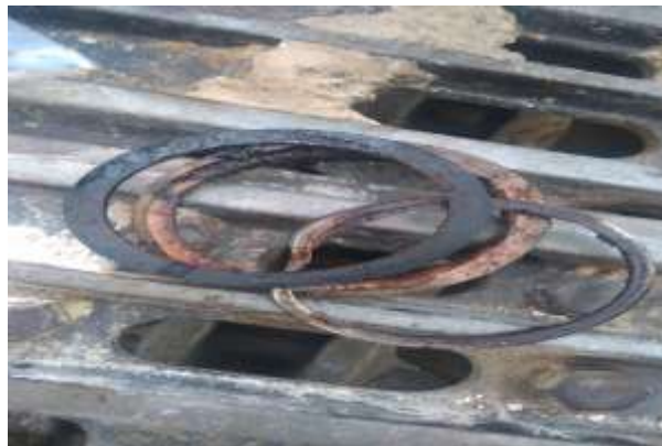
Gambar 12. Seal rod yang sudah terlepas
