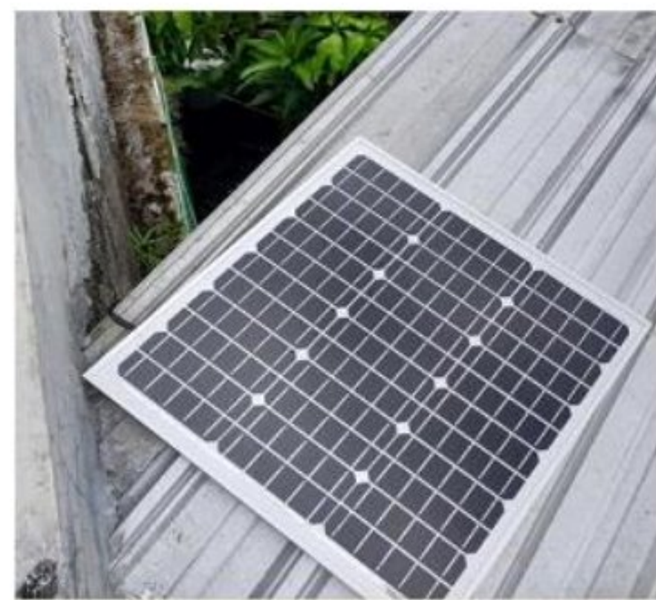
Gambar 5. Penempatan Panel Surya
