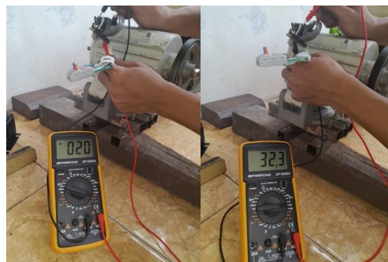
Gambar 5. Pengukuran nilai tegangan rms Output Generator dan tegangan Output Rectifier menggunakan Multimeter
