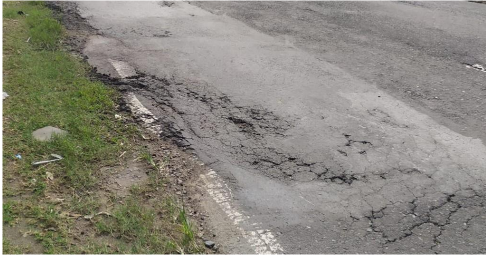
Gambar I.1 Contoh Kerusakan Jalan
